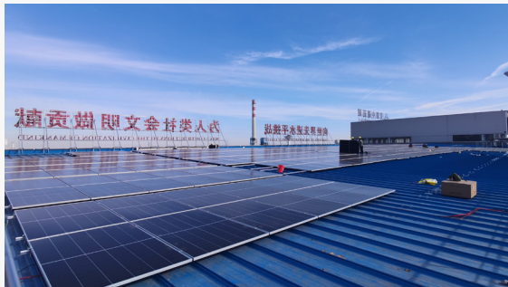
屋顶光伏发电
