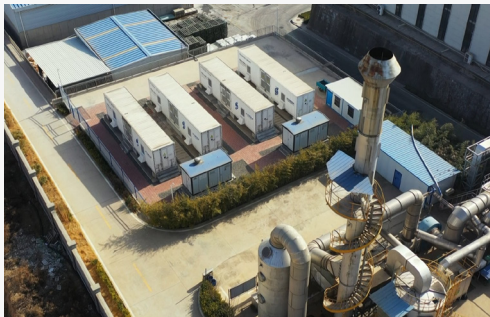
源网荷储项目储能设施
